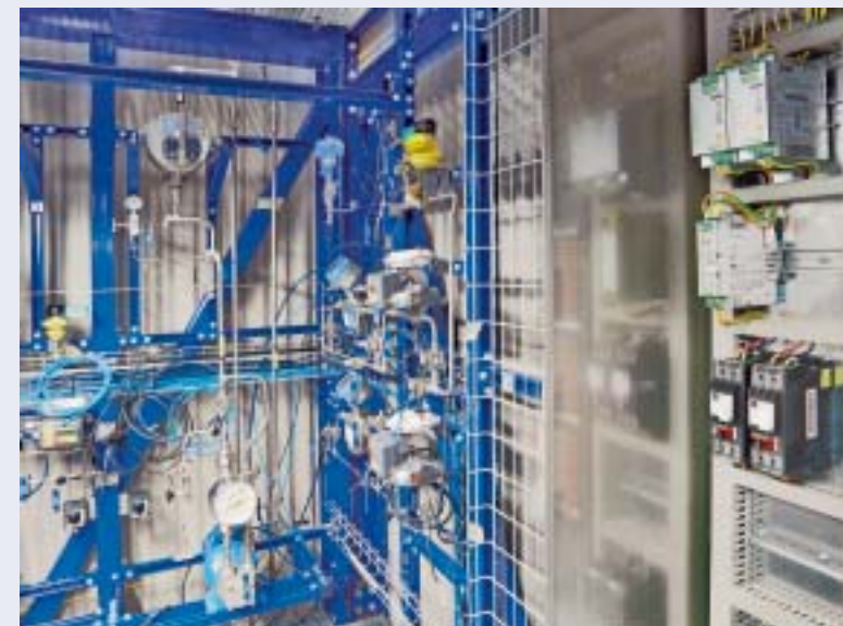
Aufgrund des redundanten Aufbaus und des aktiven Redundanzmoduls sorgen die dezentralen Schaltschränke für hohe Anlagenverfügbarkeit
