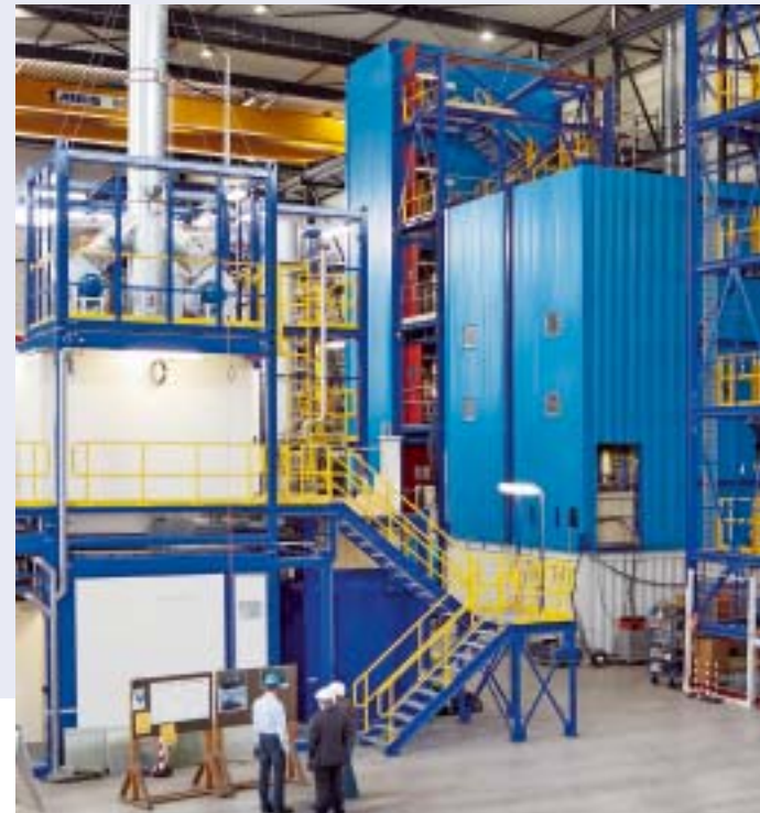
Die Pilotanlage ist eine detailgetreue Nachbildung der kommerziellen Anlage – von den Ventilen bis zum Prozessleitsystem
