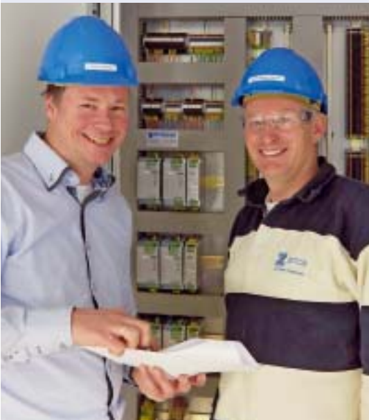
Ruud Mennink (links) und Hans Jurgen Koele (rechts) von Zeton vor dem zentralen Schaltschrank der Pilotanlage
